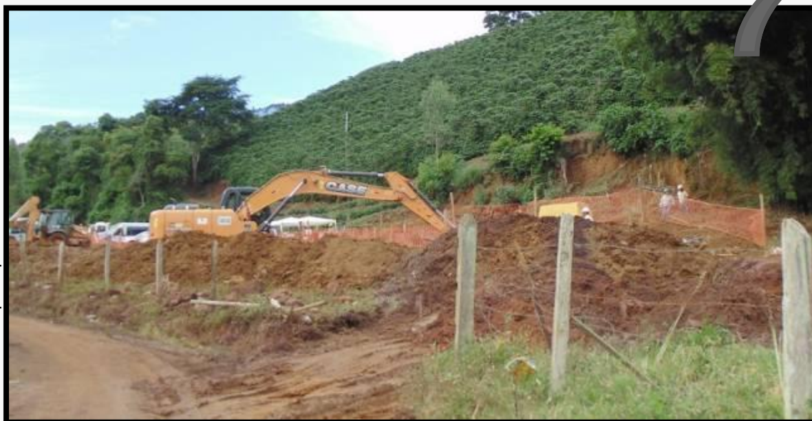
Mineroduto em São Pedro de Cima, Município de Divino — MG.
